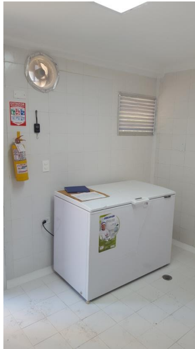
Foto 5. Nevera del cuarto de almacenamiento de residuos peligrosos.
