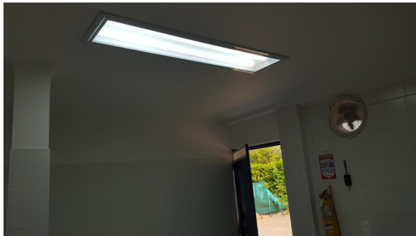
Foto 4. luminarias del cuarto de almacenamiento de residuos peligrosos.
