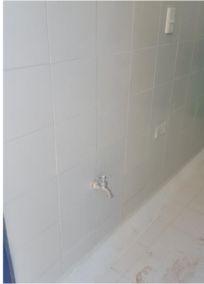
Foto 3. Sistema hidráulico del cuarto de almacenamiento de residuos peligrosos.
